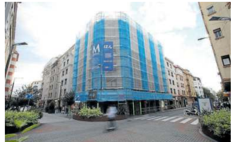
Uno de los edificios afectados. Foto: Patxi Cascante
